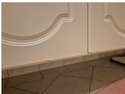
Fuktsveller i bunn av skapdør.
