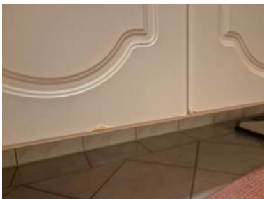
Fuktsveller i bunn av skapdør.
