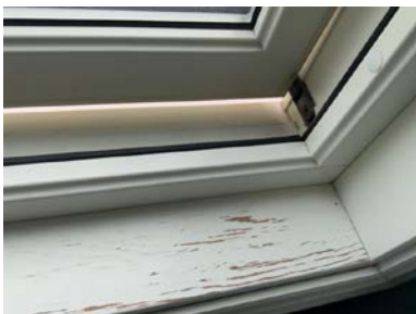
Slitasje i vindusforing
