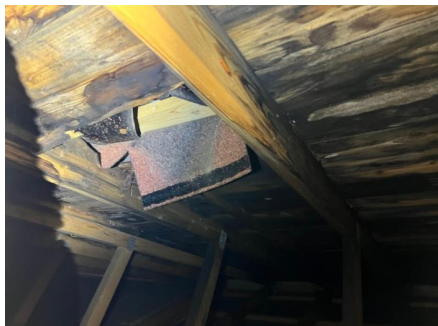
Missfarging undertak og mindre hull i taktro
