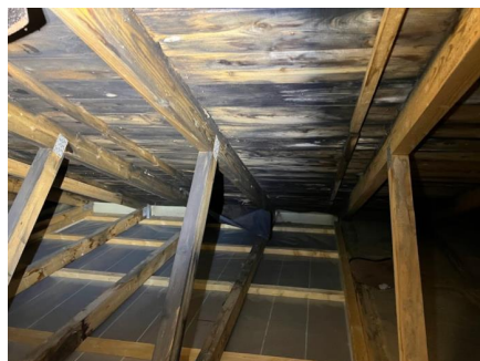
Manglende isolering i tak
