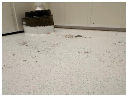
Mangelfull membran gulv/vegg
