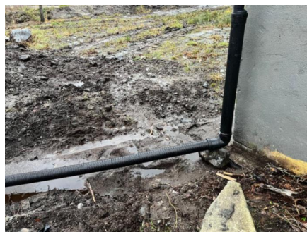
Avløpsrør fra taknedløp åpent på bakken
