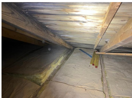
Misfarging takstoler og undertak.
