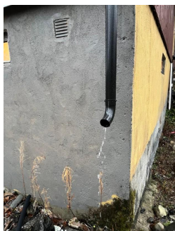
Nedløpsrør avsluttet over bakkenivå
