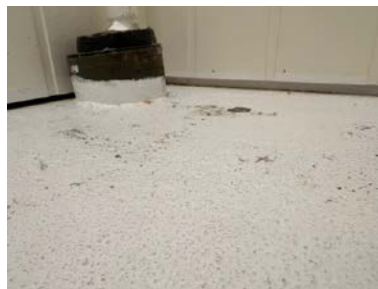
Mangelfull membran gulv/vegg
