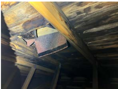
Missfarging undertak og mindre hull i taktro
