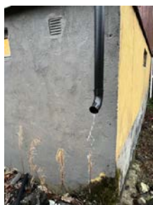
Nedløpsrør avsluttet over bakkenivå
