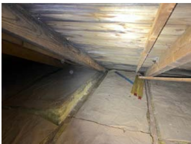
Misfarging takstoler og undertak.
