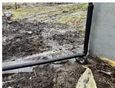
Avløpsrør fra taknedløp åpent på bakken
