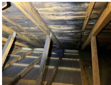
Manglende isolering i tak
