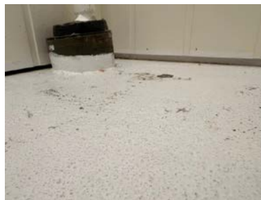
Mangelfull membran gulv/vegg
