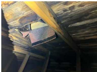
Missfarging undertak og mindre hull i taktro
