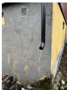
Nedløpsrør avsluttet over bakkenivå
