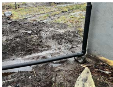
Avløpsrør fra taknedløp åpent på bakken
