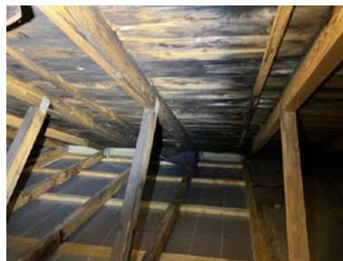
Manglende isolering i tak
