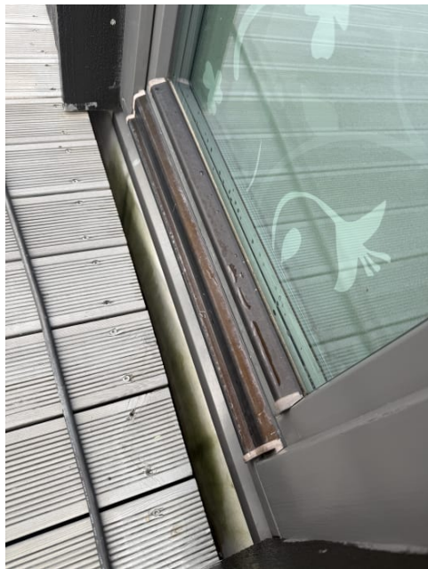
Vindu mangler beslag i bunnen.
