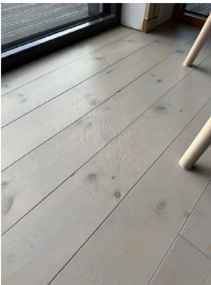
Det registreres stedvis mye hakk etter stoler.
