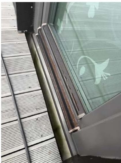
Vindu mangler beslag i bunnen.
