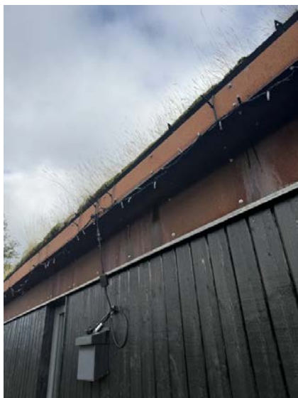
Det registreres stedvis drypp ifra takrenner.
