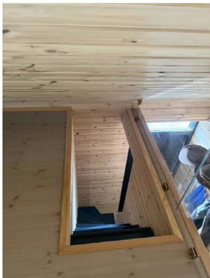
Trapp mangler rekkverk og håndløper.
