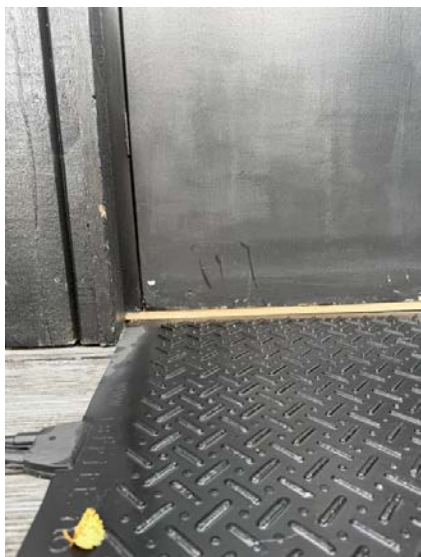
Ytterdør tar i karm og har noe slitasje i bunnen.
