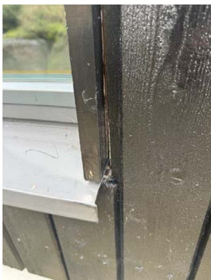
Vindu har mangelfull omramming og det er fare for at vanninntrenging bak kledning.
