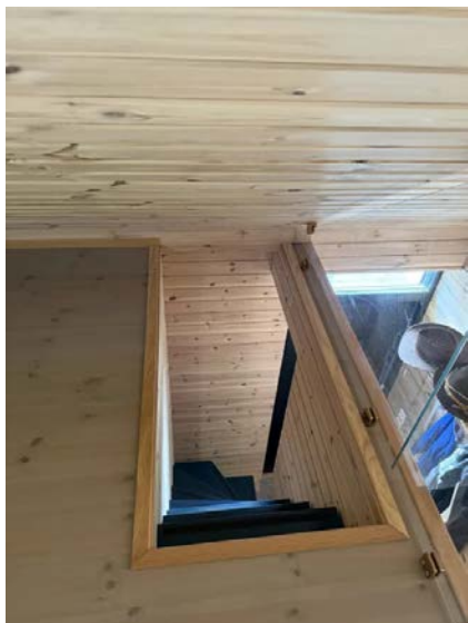
Trapp mangler rekkverk og håndløper.
