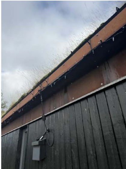
Det registreres stedvis drypp ifra takrenner.
