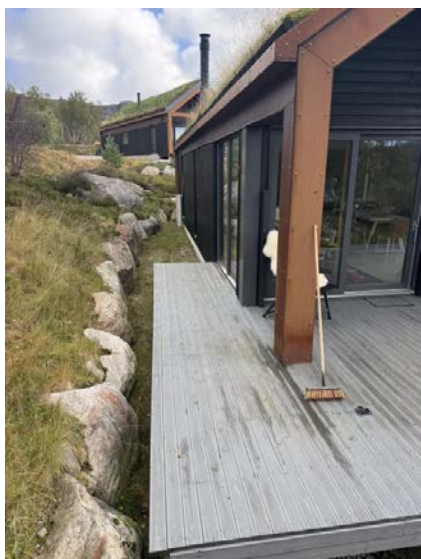
Terrassen har stedvis noe slitasje og større skjevheter.
