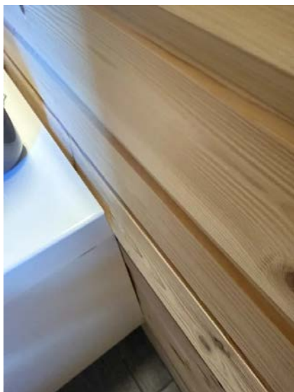
Servantskap er ikke tilstrekkelig innfestet.
