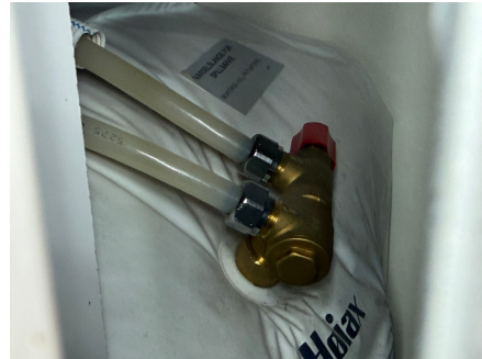
Pex bør ikke kobles direkte på varmtvannsberederen, plastrør skal ikke ha mer enn 70 grader varmtvann. Ut fra berederen bør det være trykkslanger eller kobberør minst 40cm før det koblet til plastrør.
