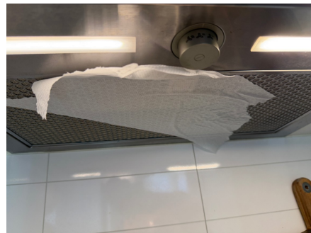
Funksjonstest av avtrekk
