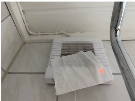
Funksjonstest av avtrekk
