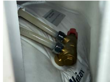
Pex bør ikke kobles direkte på varmtvannsberederen, plastrør skal ikke ha mer enn 70 grader varmtvann. Ut fra berederen bør det være trykkslanger eller kobberrør minst 40cm før det koblet til plastrør.
