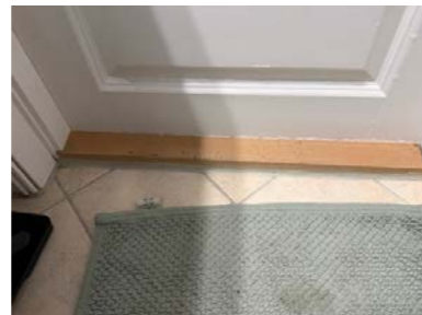
Ingen tilluft under dør
