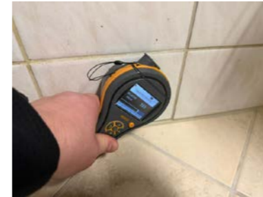
Vegg mot sovealkove, ingen utslag.
