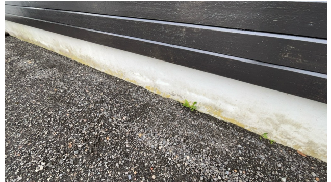
Stedvis behov for lokale utbedringer.
