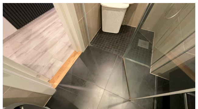
Påvist bomflis på gulv.
