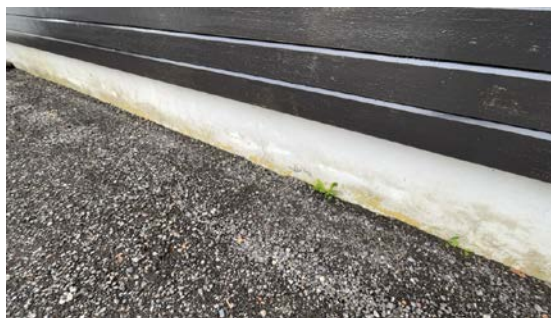
Stedvis behov for lokale utbedringer.
