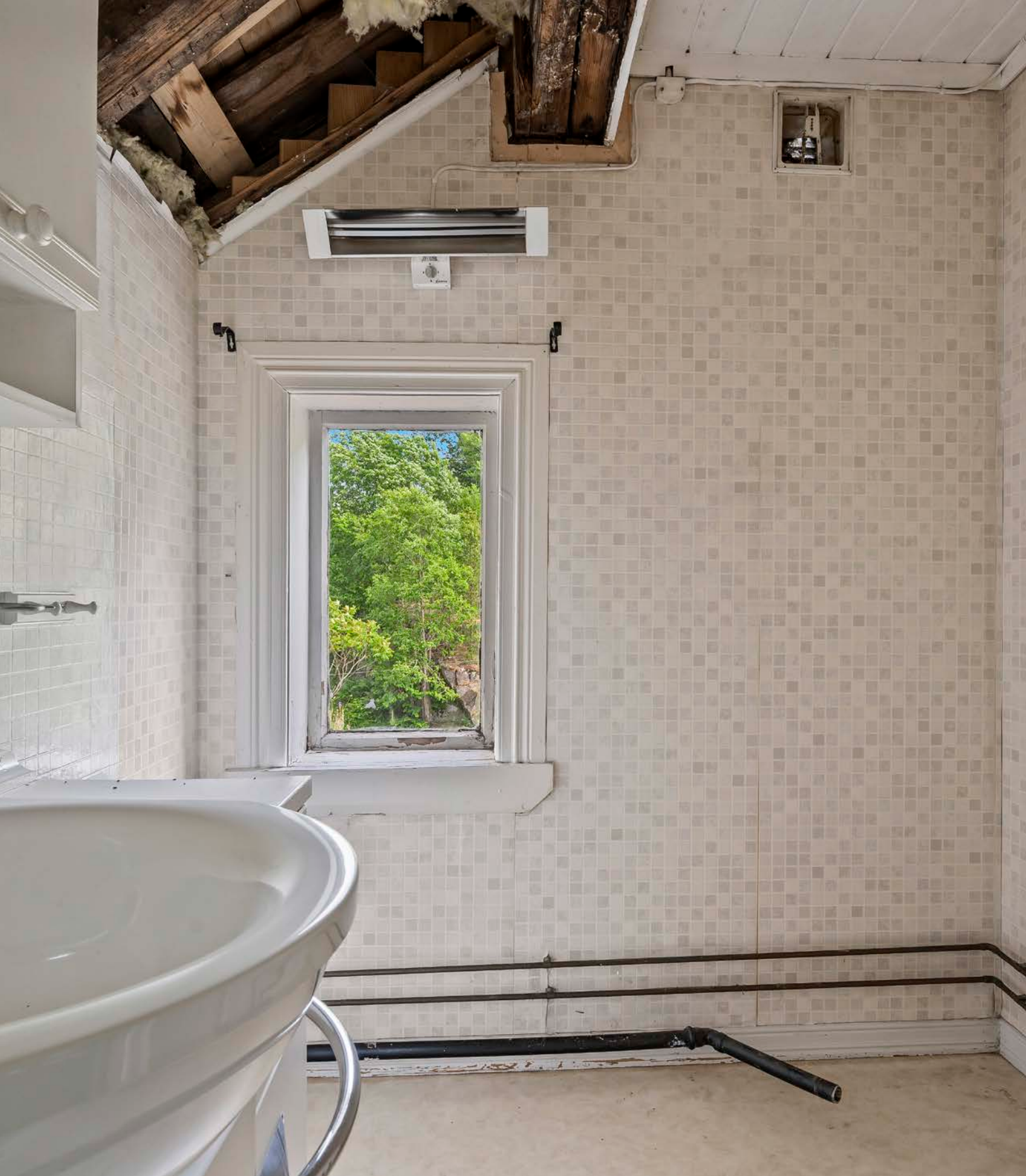
Vaskerom i 2. etasje har vært gjennom en fuktskade. Se tilstandsrapport for ytterligere info.
