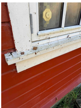
Bildet viser liten klaring mellom utvending omramming og vannbrett.
