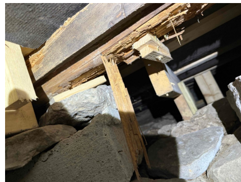
Bildet viser råte under delevæggen.
