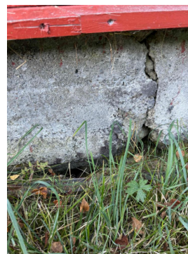
Bildet viser sprekk i grunnmuren og manglende masse under muren.
