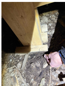
Bildet viser råte i søyle med terreng kontakt.
