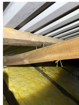
Bildet viser taksperre med brudd.
