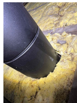
Bildet viser kondensering på stålpipes.
