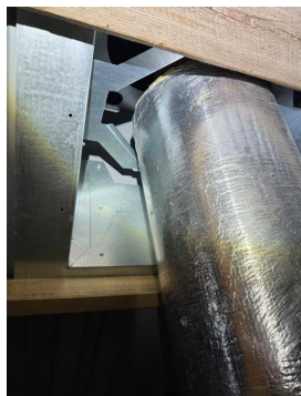
Bildet viser liten avstand mellom lekte og stålpipe.
