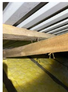
Bildet viser takspærre med brudd.
