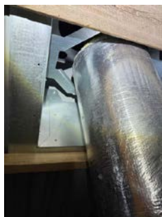
Bildet viser liten avstand mellom lekte og stålpipe.
