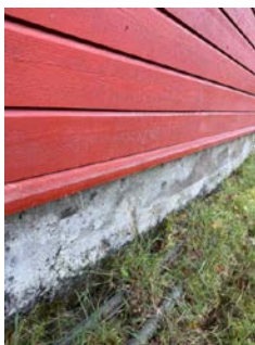
Bildet viser liten klaring mellom kledning og vannbrett.
