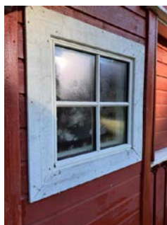
Bildet viser vinduet til rommet med forbrenningstoalett.
