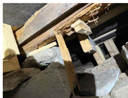
Bildet viser råte under deleveggen.
