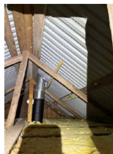
Bildet viser loft uten undertak under takplatene.
