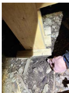
Bildet viser råte i søyle med terreng kontakt.
