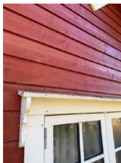
Bildet viser manglende beslag på vannbrett over vinduet.
