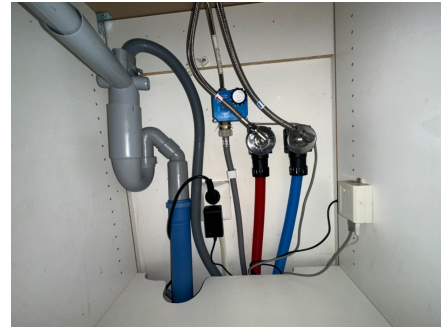
Røropplegg i kjøkkenbenk med Waterguard
