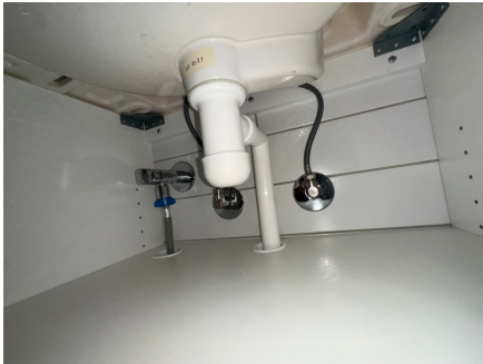
Røropplegg i servantskap
