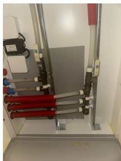
Samleskap med rørkurser og stoppekraner
