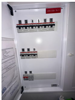
Sikringsskap med automatsikringer.
