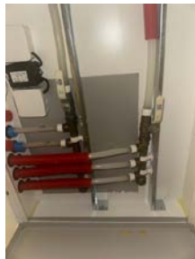
Samleskap med rørkurser og stoppekraner
