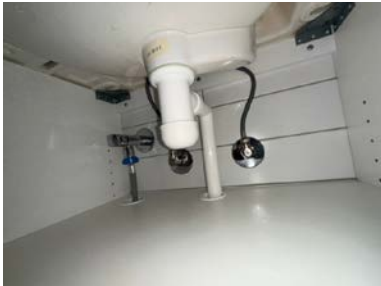
Røropplegg i servantskap
