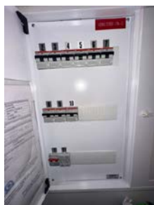
Sikringsskap med automatsikringer.
