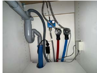
Røropplegg i kjøkkenbenk med Waterguard
