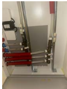
Samleskap med rørkurser og stoppekraner
