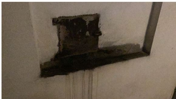
Sotluke i kjeller. Noen rennemerker.
