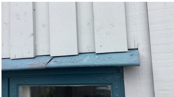
Eksempel på slitasje.
