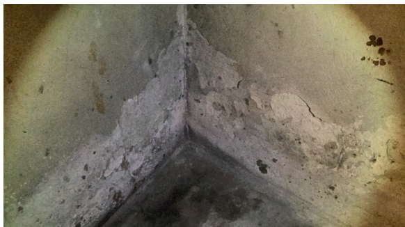
Eksempel på avskaling på vegg
