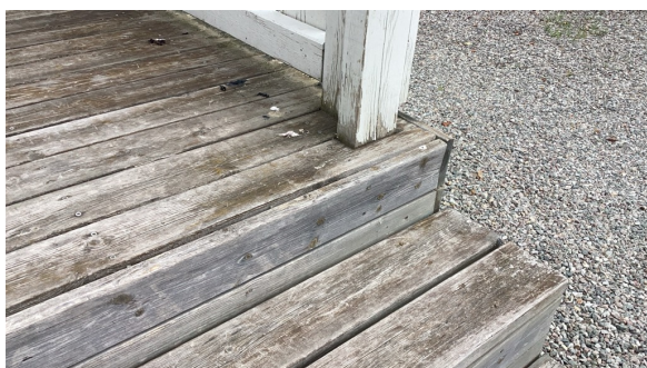
Eksempel på slitasje på veranda ved entre
