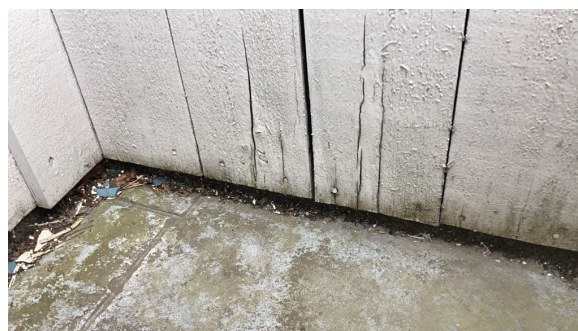
Råte i enkelte kledningsbord på balkong.
