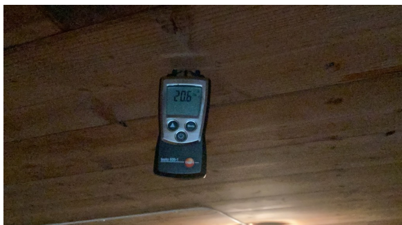
Fukttinnhold på ca. 20 vektprosent i treverk i himling.
