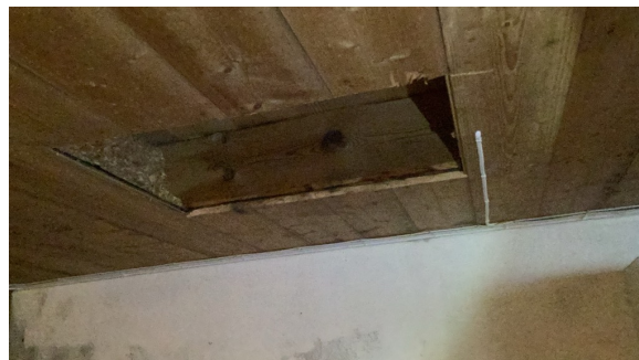
Åpnet i himling på ett punkt
