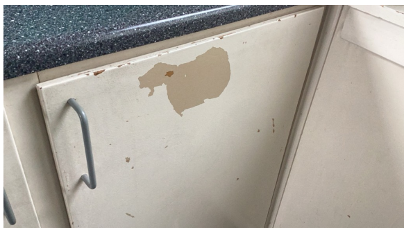
Eksempel på slitasje.
