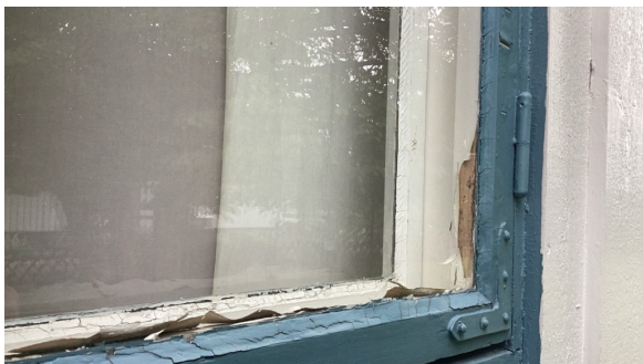
Eksempel på slitasje.
