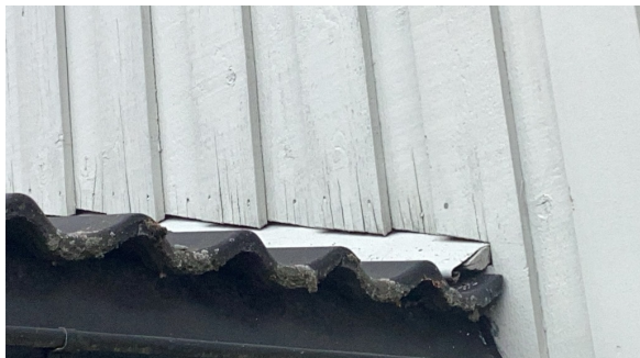
Eksempel på sprekker i kledningsbord.
