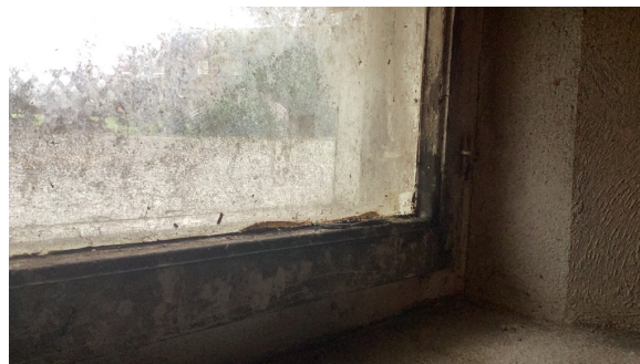
Eksempel på slitasje.
