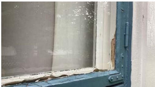
Eksempel på slitasje.
