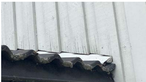
Eksempel på sprekker i kledningsbord.
