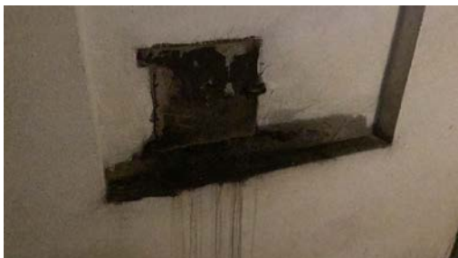
Sotluke i kjeller. Noen rennemerker.
