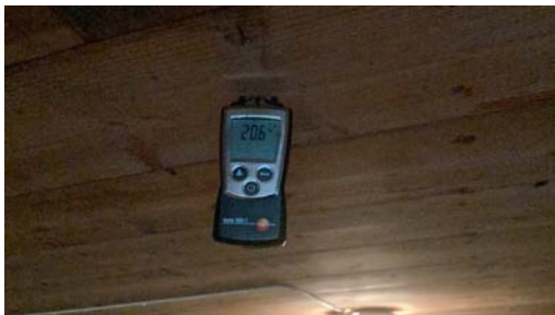
Fukttinnhold på ca. 20 vektprosent i treverk i himling.
