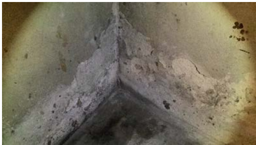
Eksempel på avskalning på vegg
