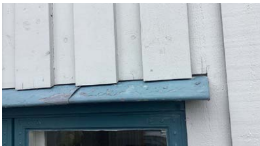
Eksempel på slitasje.
