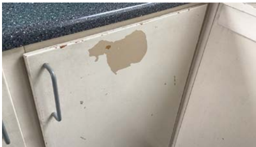
Eksempel på slitasje.
