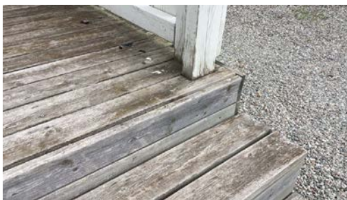
Eksempel på slitasje på veranda ved entre
