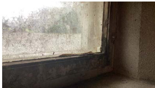
Eksempel på slitasje.
