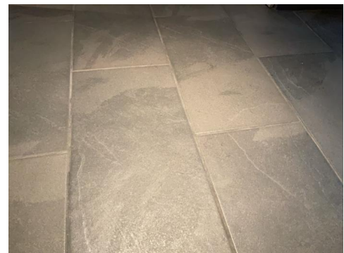
Bom (hullrom) i store deler av entre/gang gulv
