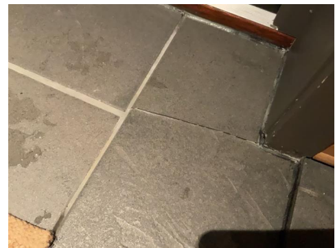
Sprekk i enkelte fliser
