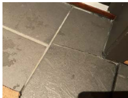
Sprekk i enkelte fliser
