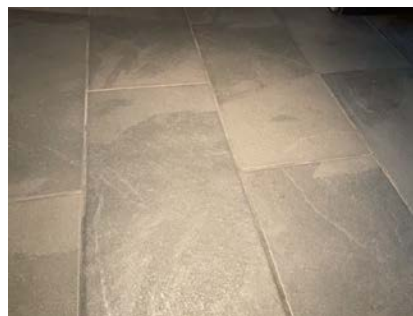
Bom (hullrom) i store deler av entre/gang gulv
