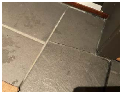
Sprekk i enkelte fliser
