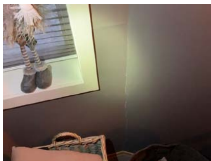
Sprekk/riss i hjørne på vegg i entre
