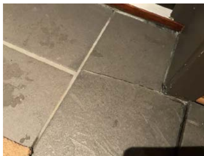
Sprekk i enkelte fliser
