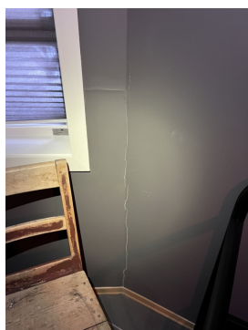
Sprekk/riss i hjørne på vegg i soverom/garderobe
