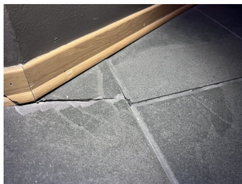
Sprekk i enkelte fliser
