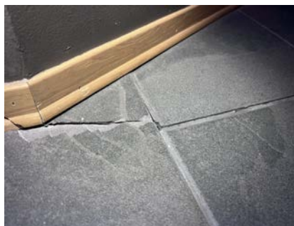
Sprekke i enkelte fliser
