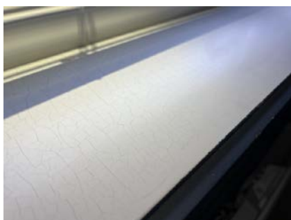
Bemerket sprekkdannelse på maling i utforing/karm
