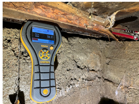
Påvist råte og målt skadelig fukt i bjelke.
