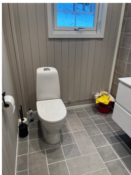
Trepanel og gulvlist er ført ned til gulvfliser.
