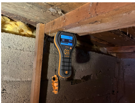
Fuktmålinger viste normale verdier.
