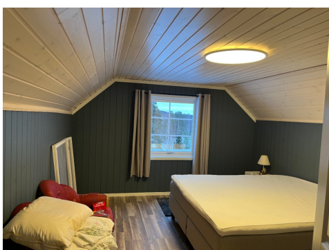
Mangelfull ventilasjon i bl.a. soverom
