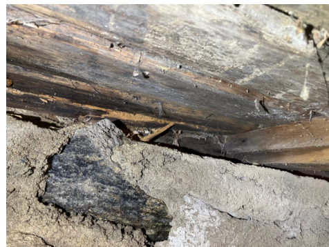
Råteskader i stubbloft.
