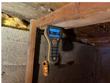
Fuktmålinger viste normale verdier.
