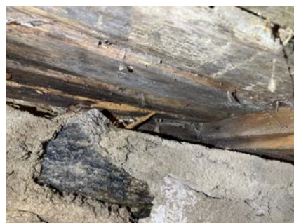
Råteskader i stubbloft.
