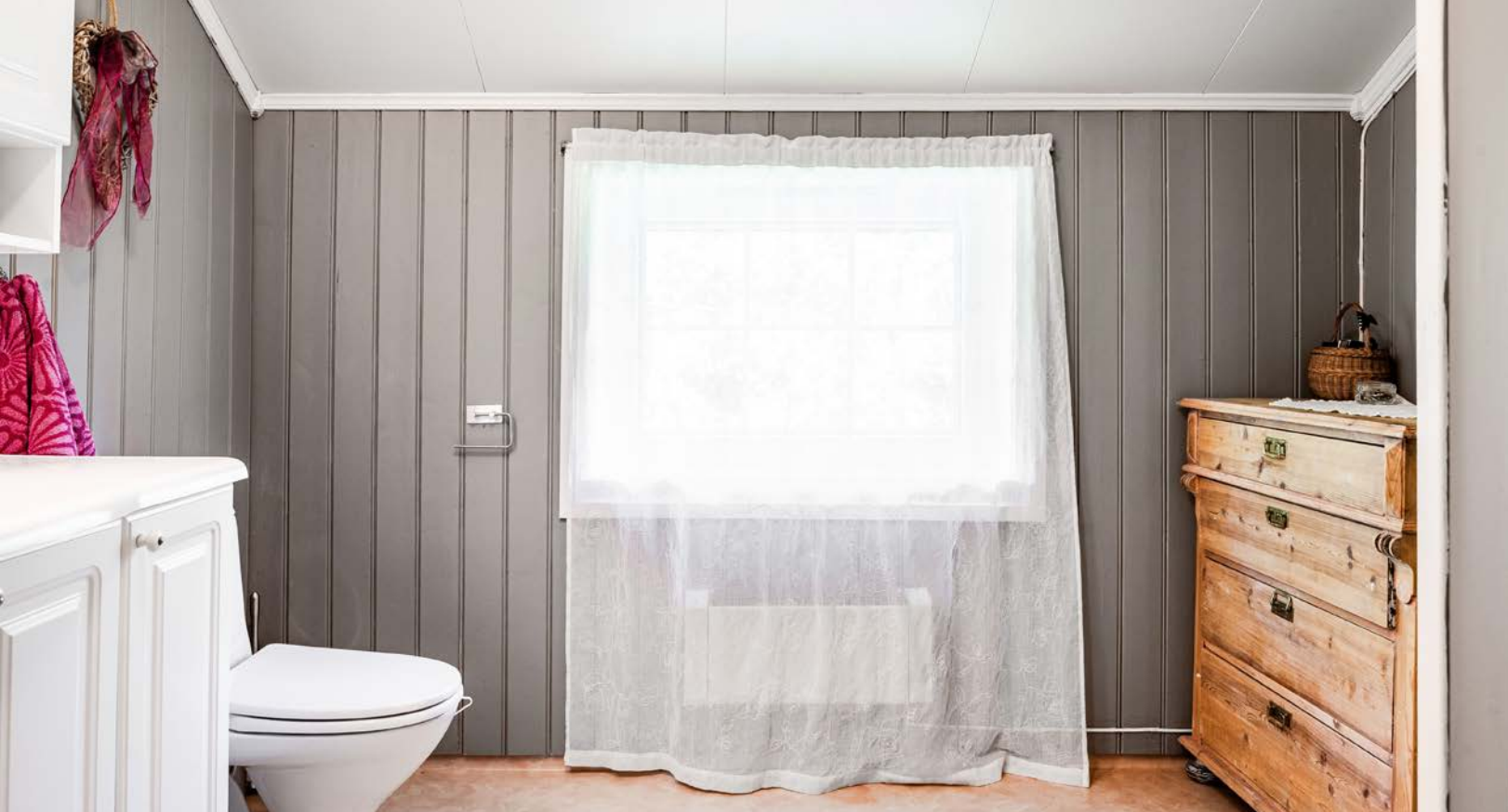
Baderommet i 2. etasje er fra 1990-tallet. Baderommet har fått TG3 i tilstandsrapporten og det anbefales at rommet totalrenoveres.
