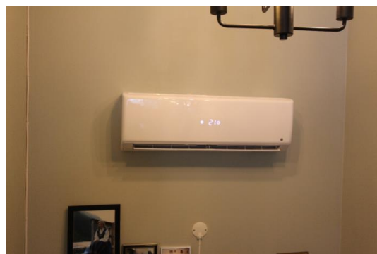
Varmepumpe i trapperommet.
