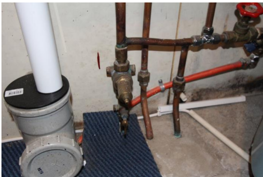
Stoppekran og reduksjonsventil.
