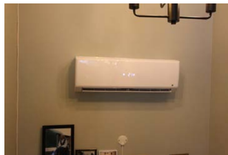
Varmepumpe i trapperommet.
