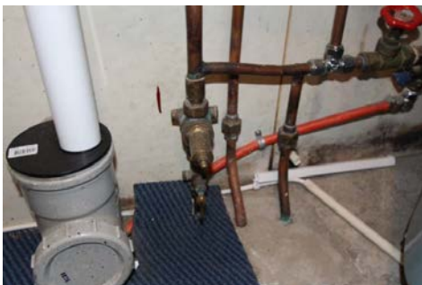
Stoppekran og reduksjonsventil.
