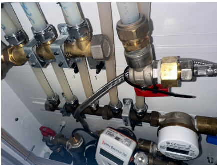
Stoppekraner plassert på bad
