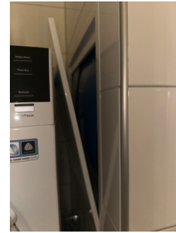
Samleskap med rørkurser og stoppekraner
