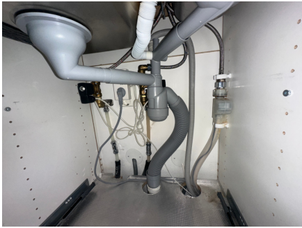
Røropplegg i kjøkkenbenk med Waterguard
