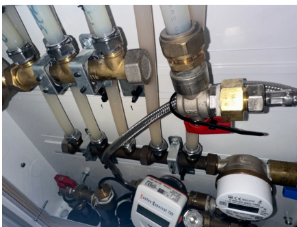
Stoppekraner plassert på bad
