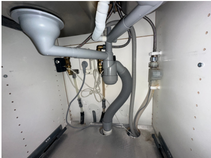
Rørplog i kjøkkenbenk med Waterguard
