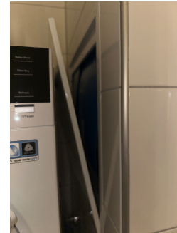
Samleskap med rørkurser og stoppekraner
