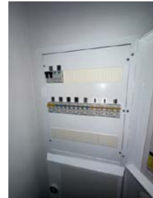
Sikringskap med automatsikringer.
