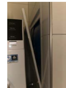
Samleskap med rørkurser og stoppekraner
