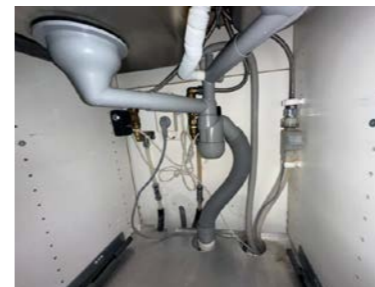
Røropplegg i kjøkkenbenk med Waterguard
