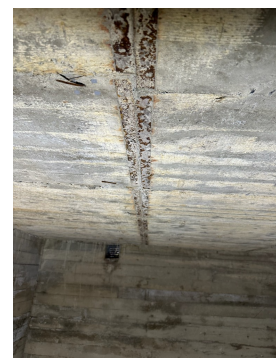
Noe rustdannelser på støpeskiner.
