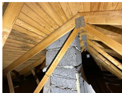
Kontroll rundt pipeløp. Synlige fuktflekker rundt pipeløp dog ingen høy fuktprosent ble påvist på befaringsdagen.
