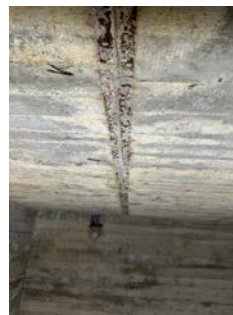
Noe rustdannelse på støpeskinner.
