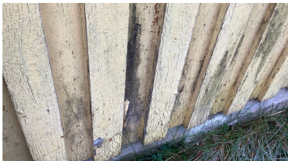
Eksempel på værslitt kledning.
