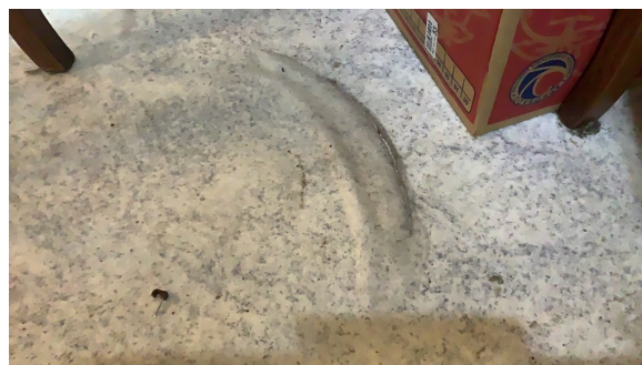
Eksempel på slitasje i gulvbelegg.
