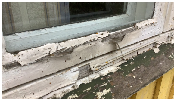
Eksempel på værslitt vindu.
