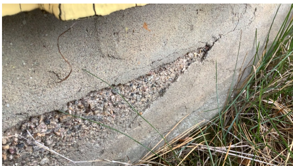
Løst puss på ringmur.
