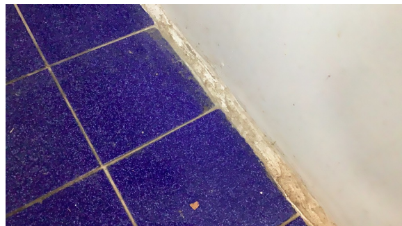
Fliser er ikke fagmessig montert.
