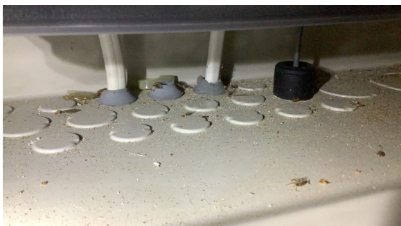
Innføringer i sikringsskap er utette.
