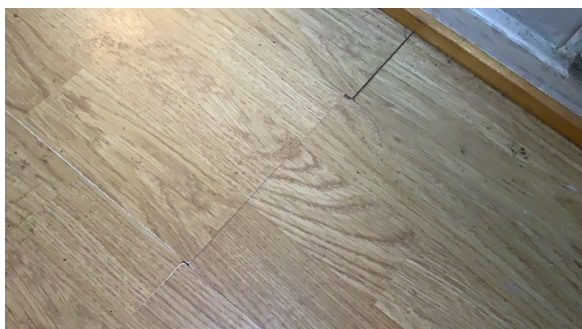
Enkelt skjøtet laminatgulv med glippe i skjøt.
