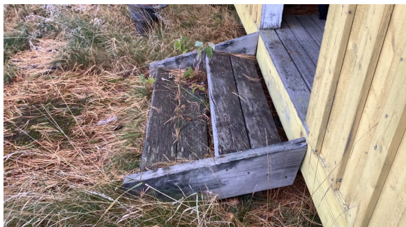
Skjev og værslitt trapp.
