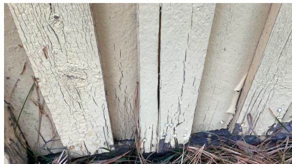
Eksempel på værslitt og sprukket kledning.
