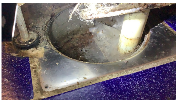
Det er ikke synlig tettesjikt rundt sluk.
