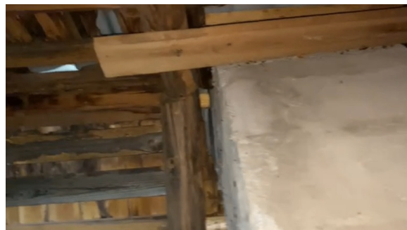
Fuktskjolder inntil pipe.
