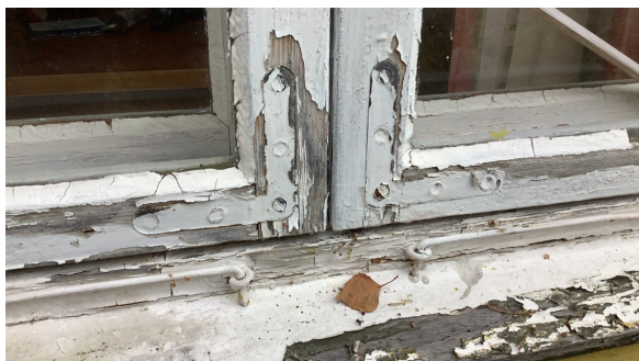
Eksempel på værslitt vindu.
