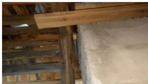
Fuktskjolder inntil pipe.
