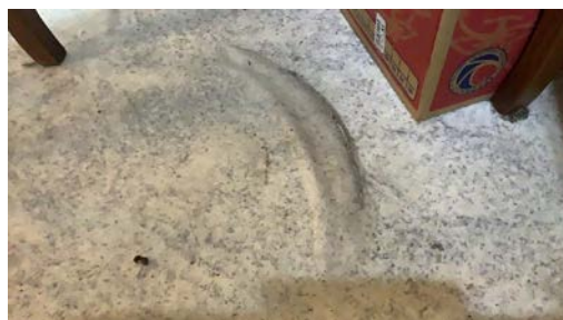
Eksempel på slitasje i gulvbelegg.
