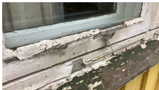
Eksempel på værslitt vindu.
