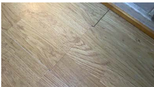
Enkelt skjøtet laminatgulv med glippe i skjøt.
