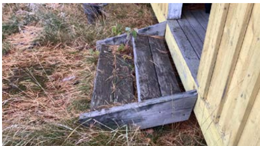
Skjev og værslitt trapp.
