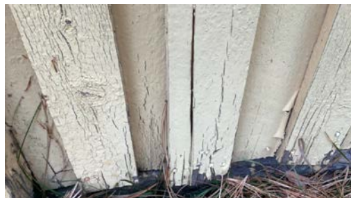
Eksempel på værslitt og sprukket kledning.
