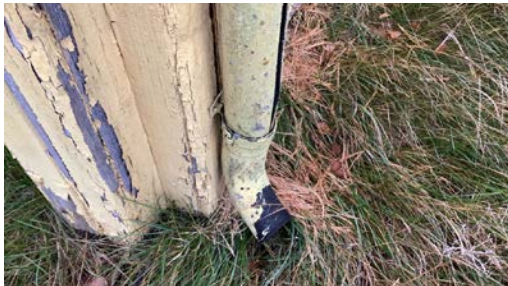
Eksempel på frostsprengt nedløpsrør og mangelfull bortledning av takvann.
