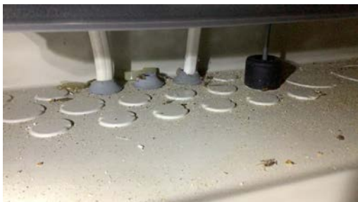
Innføringer i sikringsskap er utette.
