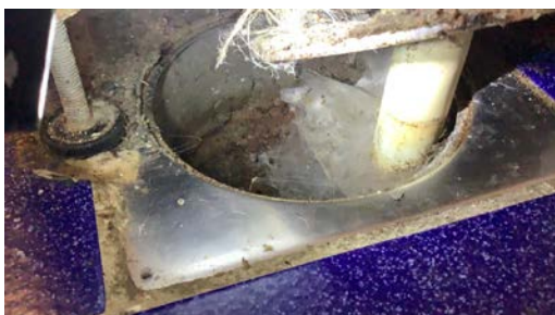
Det er ikke synlig tettesjikt rundt sluk.
