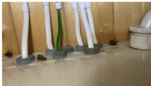
Innføringer i sikringsskap er utette.
