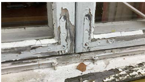
Eksempel på værslitt vindu.
