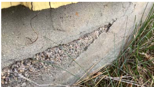
Løst puss på ringmur.
