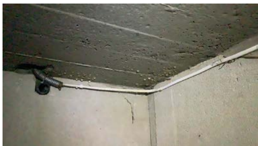
Det kondenserer på undersiden av betongdekket.
