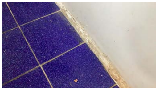
Fliser er ikke fagmessig montert.
