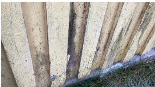
Eksempel på værslitt kledning.
