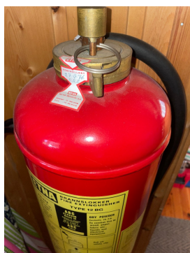
Brannslukningsapparat over 10 år gammel
