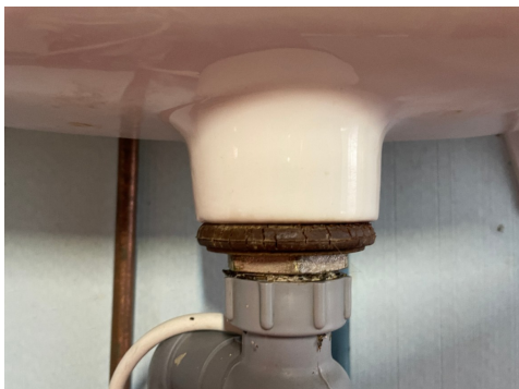
Oppsprukket pakning på avløpsrør.
