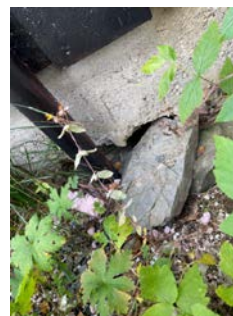
Løse steiner under ringmur på kortvegg mot øst
