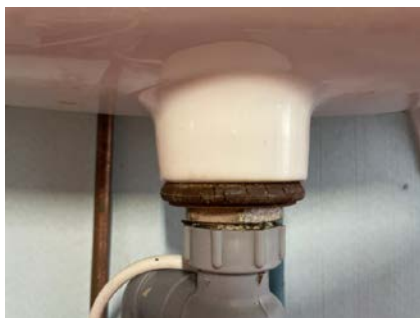
Oppsprukket pakning på avløpsrør.
