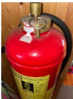
Brannslukningsapparat over 10 år gammel
