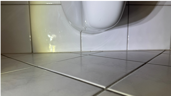
Manglende drensåpning under den innebygde sisternen.
