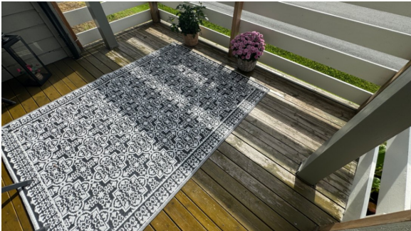
Terrassedekket er noe værslitt.
