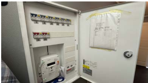
Kontroll av el-skap og kursfortegnelse.
