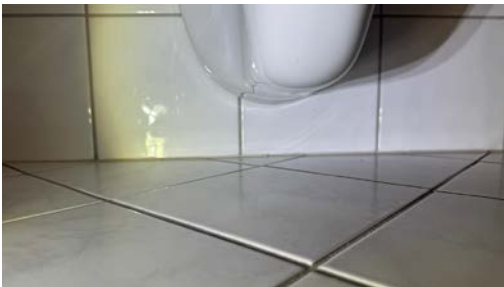
Manglende drensåpning under den innebygde sisternen.
