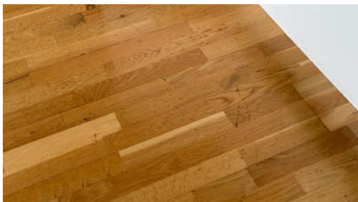
Det er registrert noe bruksslitasje på enkelte overflater.
