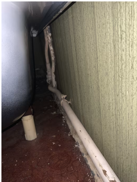
Viser rustdannelser på vannrør under badekar.
