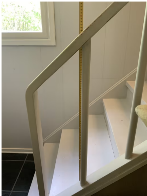
Viser høyde rekkverk, høyde mindre enn 90cm..
