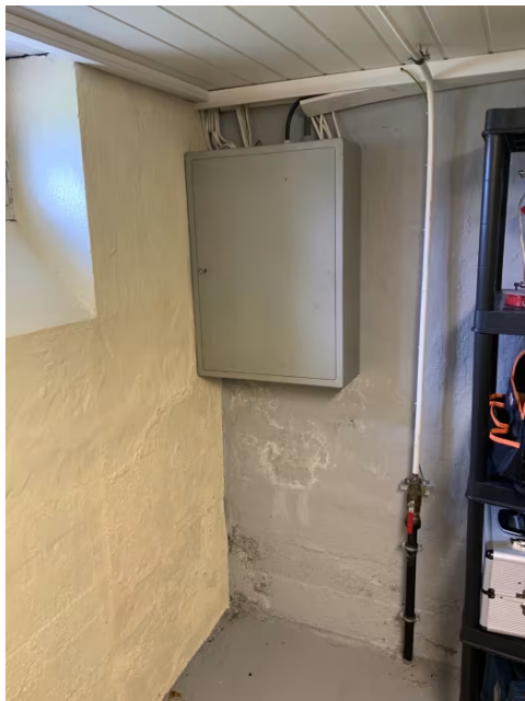
Viser sikringssskap plassert i kjeller.
