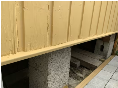
Viser oppsprekking av endeved.
