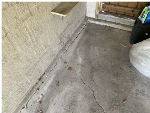
Viser sprekker i gulv og overgang gulv og fundament.
