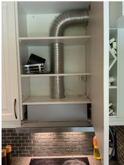
Viser ventilator over stekesonen.
