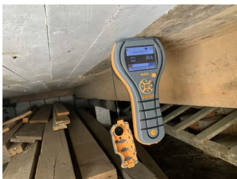
Viser utført fuktmåling i tre, måling viser fuktnivå over faregrensen.
