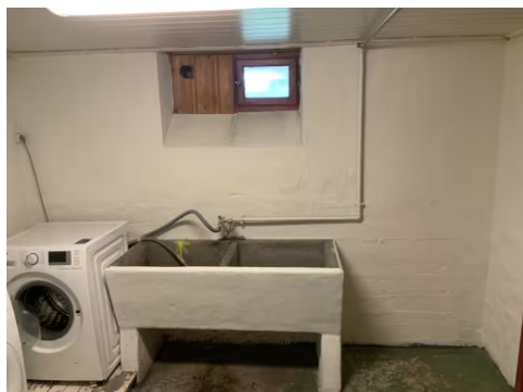
Viser frittstående stor kum av betong med to kummer, veggmontert kaldtvannskran.
