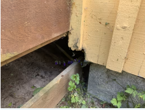
Viser registrert råteskade.
