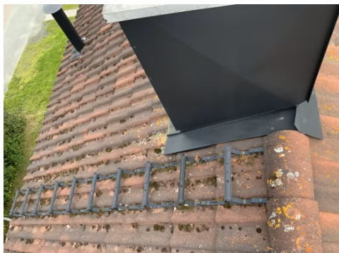
Viser etablert fastmontert stige forbi pipa.
