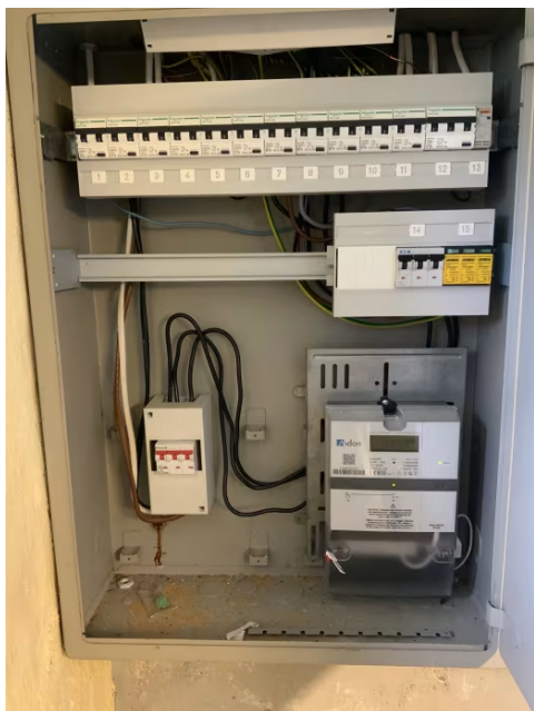
Viser sikringssskap med 63A overbelastningsvern, overspenningsvern, elektronisk strømmåler, rele for utelys og automatsikringer.
