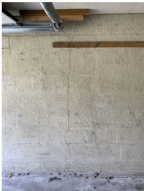
Viser registreres sprekk i murfasaden.
