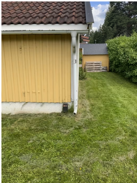
Viser nedløpsrør med buling/skade.
