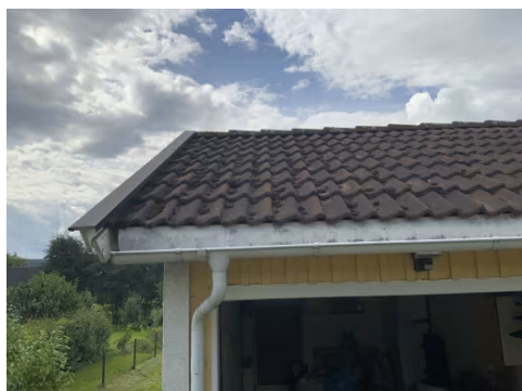
Viser begroing på taktekking.
