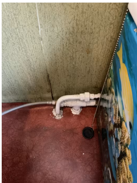
Viser registrert oppsprekninger og svelling av vinyl på vegg.
