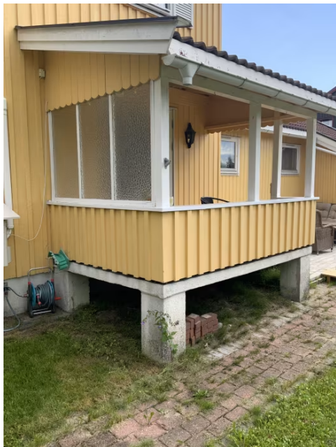
Viser manglende taknedløp.
