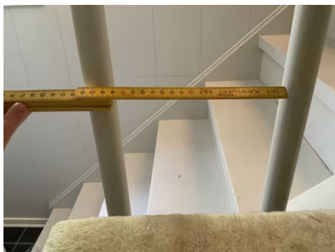
Viser åpning rekkverk, åpning større en 10cm.
