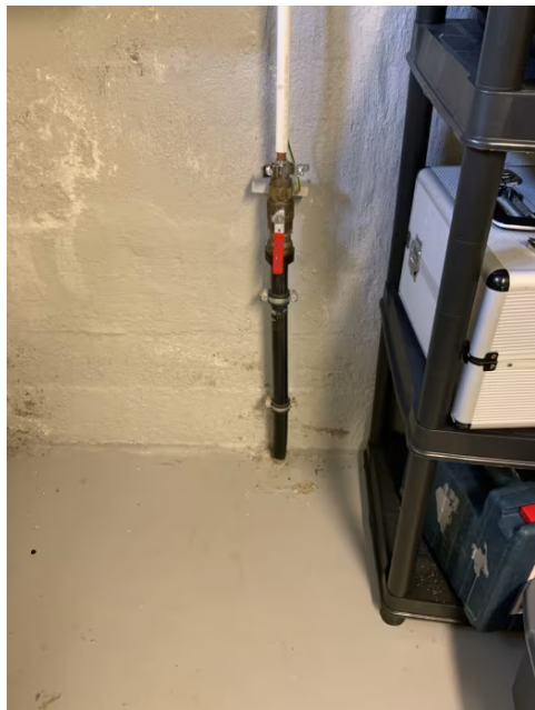
Viser plassering av hovedstoppekran i kjeller.
