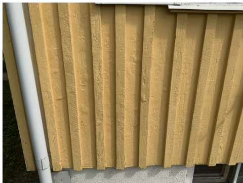
Viser registrert blæring i overflatebehandling/malingen.
