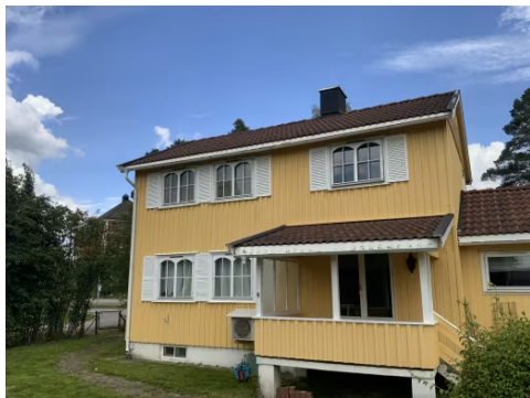
Viser takflate med manglende snøfangere.
