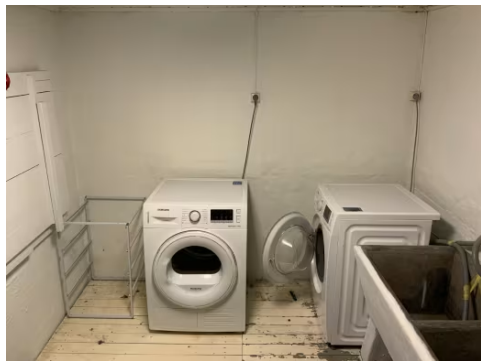
Viser opplegg og plass for vaskemaskin. Åpne rørføringer av kobberør og jernrør.
