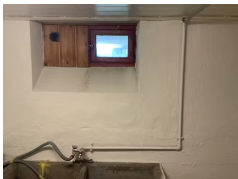
Viser uisolerte vannrør i kjeller.
