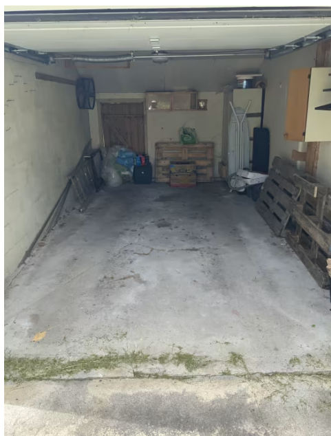
Viser sprekker i gulv og overgang gulv og fundament.
