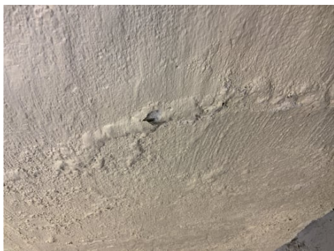
Viser mineralutslag (salt/kalkutslag) i overflater.
