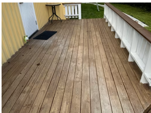
Viser slitasje på gulv.
