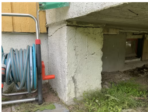
Viser sprekk i fundament.
