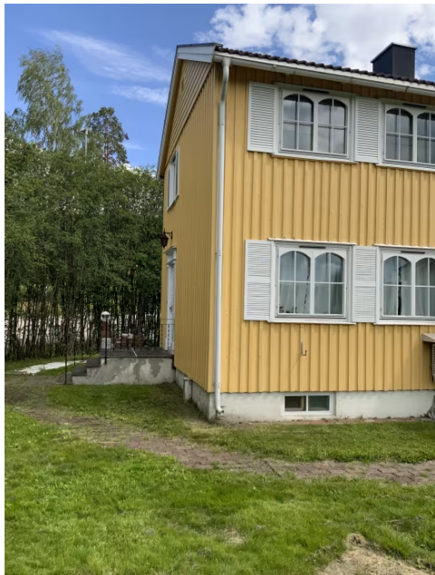
Viser nedløpsrør med buling/skade.
