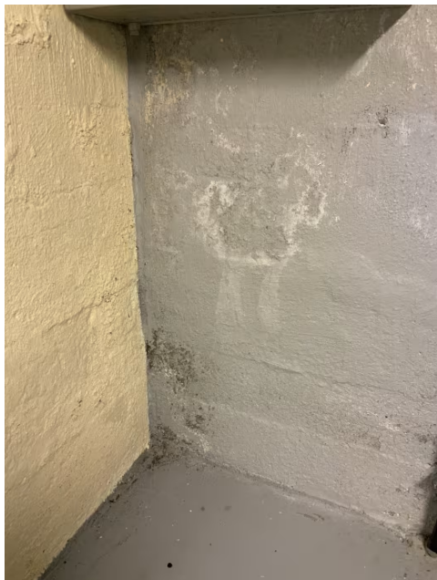
Viser mineralutslag (salt/kalkutslag) i overflater.
