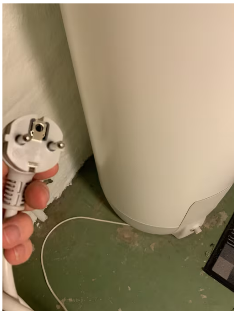
Viser plugg (støpsel) på bereder, ingen tegn til varmegang.
