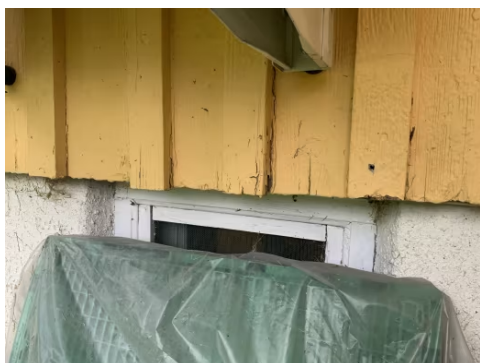
Viser oppsprekking av endeved.
