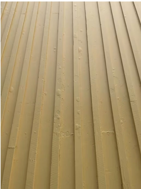
Viser registrert blæring i overflatebehandling/malingen.
