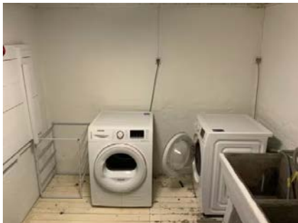
Viser opplegg og plass for vaskemaskin. Åpne rørføringer av kobberør og jernrør.
