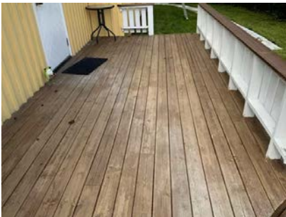
Viser slitasje på gulv.
