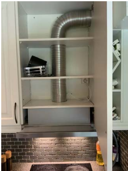
Viser ventilator over stekesonen.
