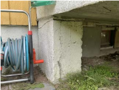
Viser sprekk i fundament.
