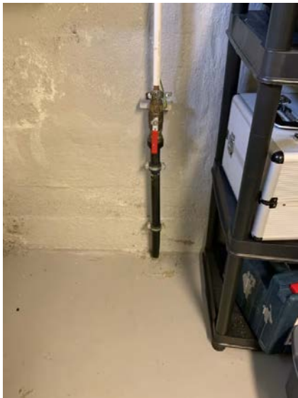
Viser plassering av hovedstoppekran i kjeller.
