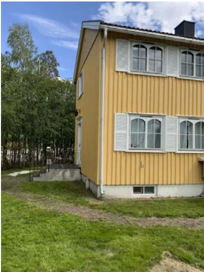
Viser nedløpsrør med buling/skade.
