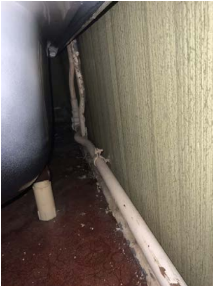
Viser rustdannelser på vannrør under badekar.
