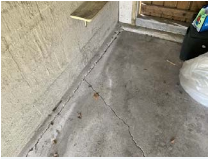
Viser sprekker i gulv og overgang gulv og fundament.
