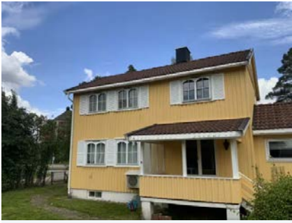
Viser takflate med manglende snøfangere.
