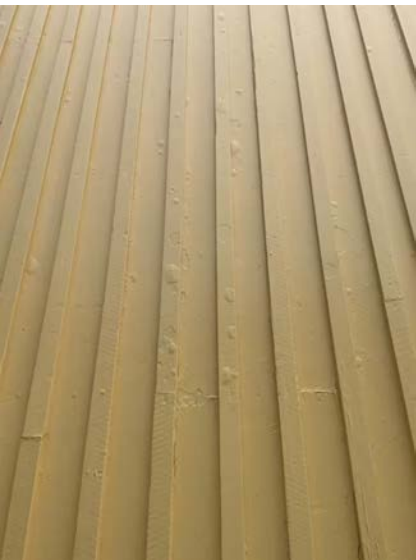
Viser registrert blæring i overflatebehandling/malingen.
