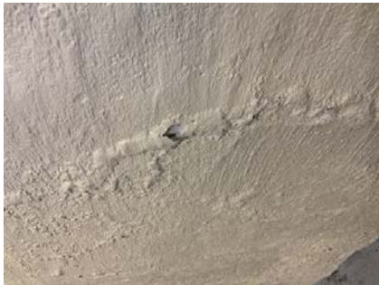
Viser mineralutslag (salt/kalkutslag) i overflater.
