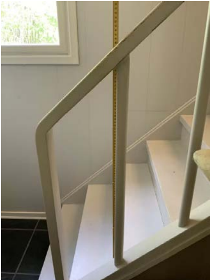
Viser høyde rekkverk, høyde mindre enn 90cm..
