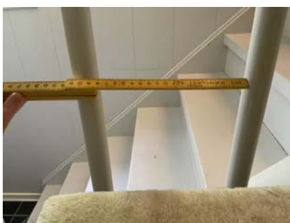
Viser åpning rekkverk, åpning større en 10cm.
