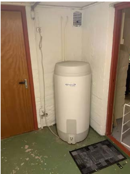
Viser plassering av varmtvannsbereder i kjeller.
