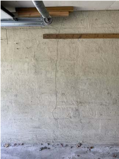
Viser registreres sprekk i murfasaden.
