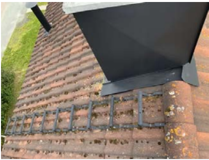
Viser etablert fastmontert stige forbi pipa.
