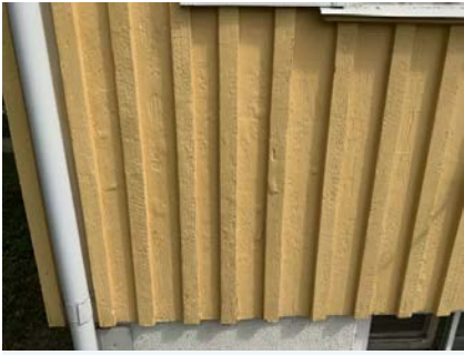
Viser registrert blæring i overflatebehandling/malingen.
