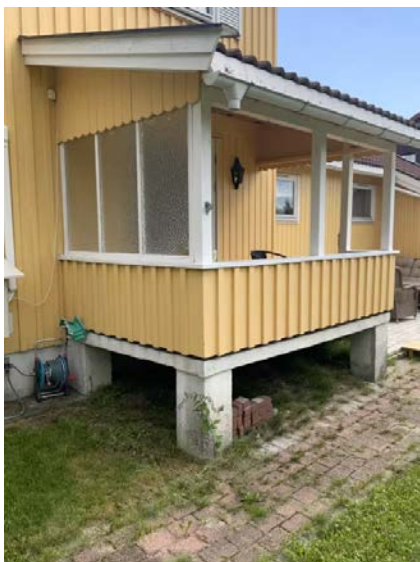
Viser manglende taknedløp.
