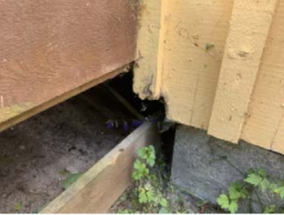
Viser registrert råteskade.
