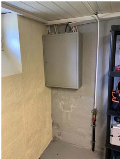
Viser sikringsskap plassert i kjeller.
