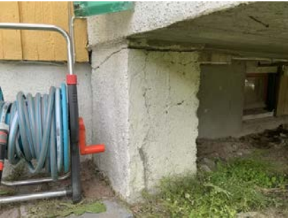
Viser sprekk i fundament.
