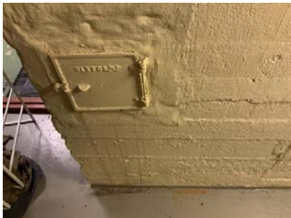
Viser feieluke i kjeller.
