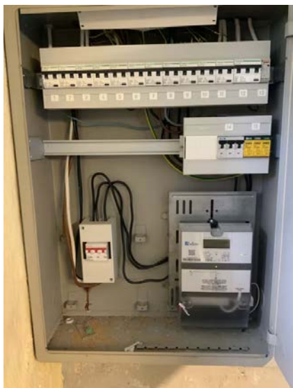
Viser sikringsskap med 63A overbelastningsvern, overspenningsvern, elektronisk strømmåler, rele for utelys og automatsikringer.
