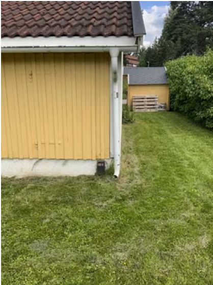
Viser nedløpsrør med buling/skade.
