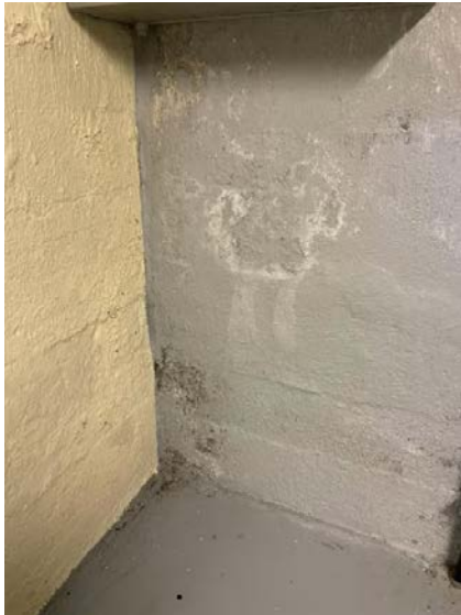
Viser mineralutslag (salt/kalkutslag) i overflater.
