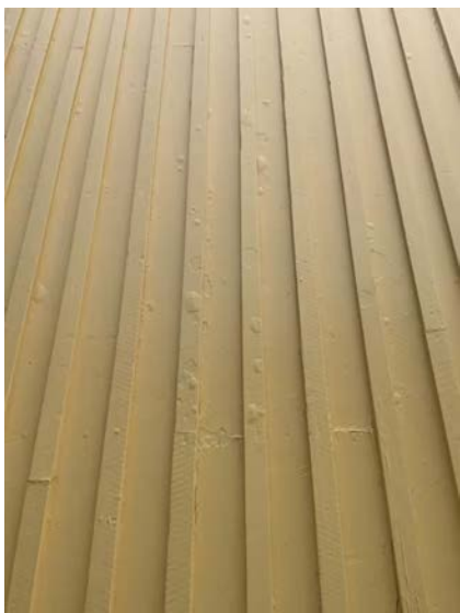
Viser registrert blæring i overflatebehandling/malingen.
