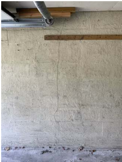
Viser registreres sprekk i murfasaden.
