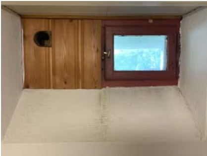
Viser vindu i kjeller fra byggeår.
