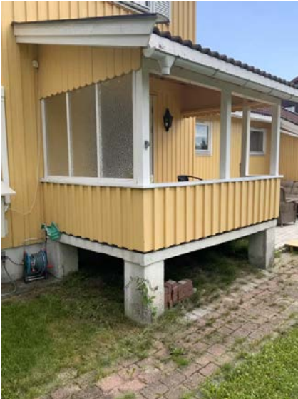
Viser manglende taknedløp.
