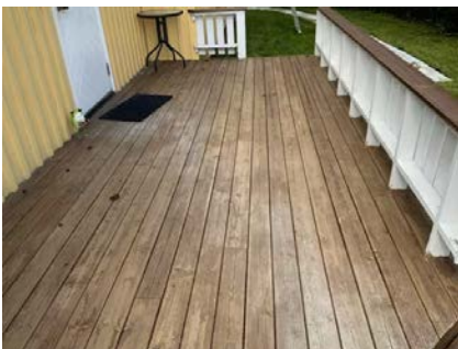
Viser slitasje på gulv.
