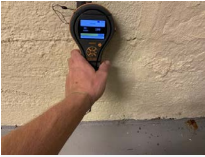
Viser fuktsøk på fritt eksponert vegg.
