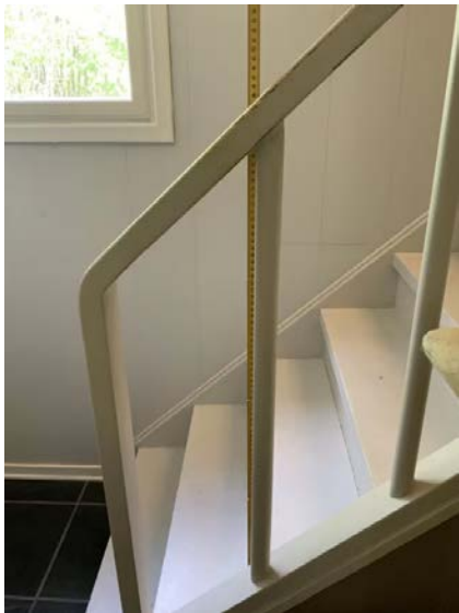
Viser høyde rekkverk, høyde mindre enn 90cm..
