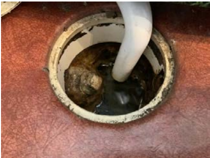
Viser støpejernsluk fra byggeår, forhøyningsring og klemring.
