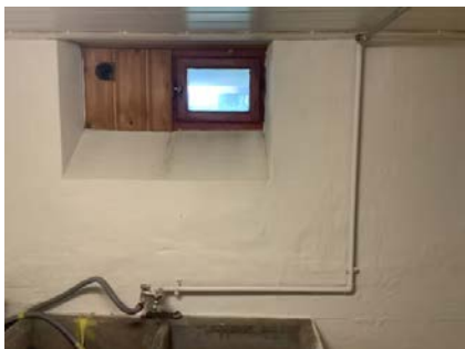
Viser uisolerte vannrør i kjeller.
