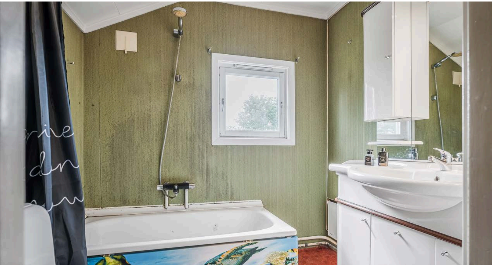
I tilknytning til soverommene i 2. etasje er det et eldre badrom som må totalrenoveres.
