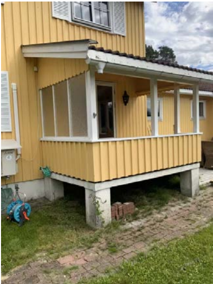
Viser takflate med manglende nedløpsrør.
