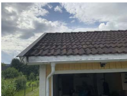
Viser begroing på takteking.
