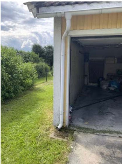
Viser takrenne og nedløpsrør med behov for rengjøring.
