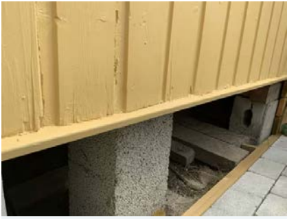
Viser oppsprekking av endevved.
