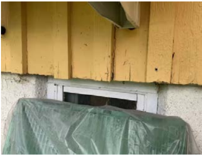
Viser oppsprekking av endeved.
