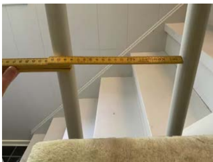
Viser åpning rekkverk, åpning større en 10cm.
