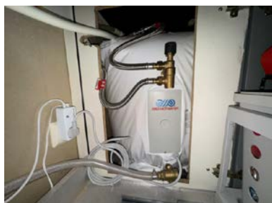
Varmtvannsbereider og waterguard
