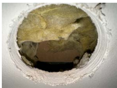
Hulltaking i tilstøtende soverom
