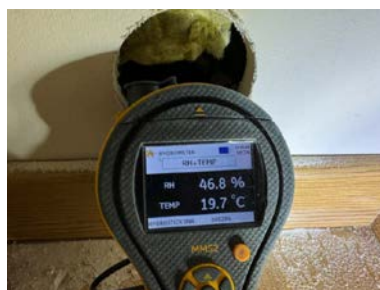
Hulltaking i tilstøtende soverom
