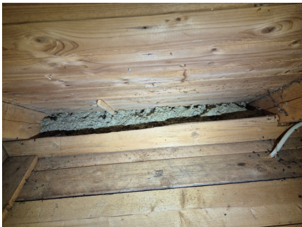
Ingen lufting i nedre del.
