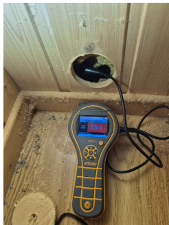
Målt høye fuktverdier i innforet vegg.
