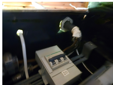
Kabelinnføringer til sikringsskap er ikke tette. (TG 3)
